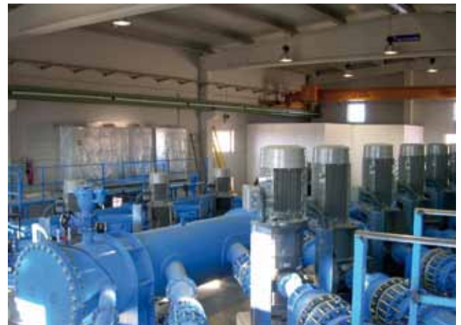
ESTACIÓN DE BOMBEO MONTE SASO DE BIOTA
