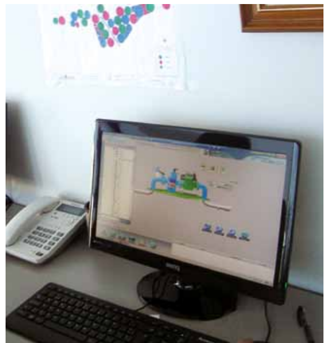
TELECONTROL MONTE SASO DE BIOTA EN LAS OFICINAS DE LA COM. DE EJEA
